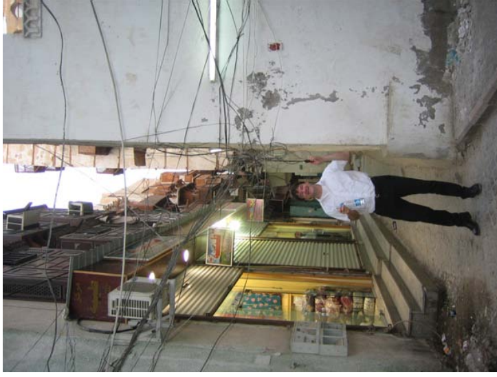
Dr. Josef Weidendorfer inspiziert die fachmännisch durchgeführte LAN-Verkabelung in der Innenstadt von Jeddah
