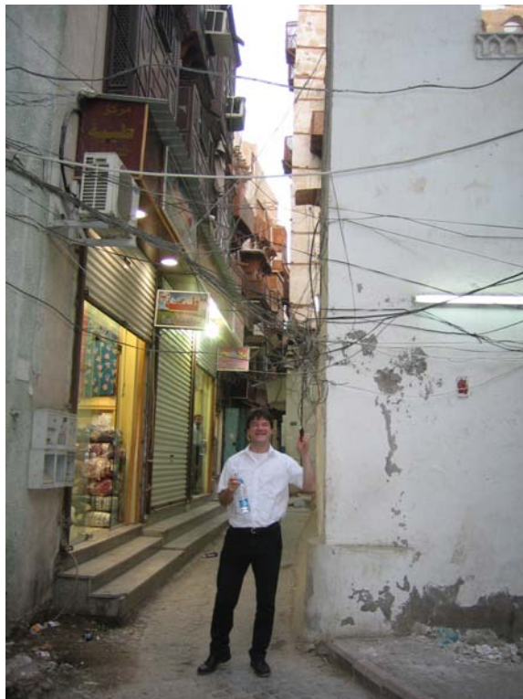
Dr. Josef Weidendorfer inspiziert die fachmännisch durchgeführte LAN-Verkabelung in der Innenstadt von Jeddah
