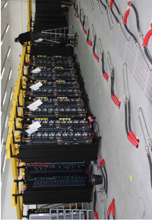
Aufbau des SuperMUC im Rechnergebäude des LRZ
