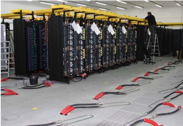
Aufbau des SuperMUC im Rechnergebäude des LRZ
