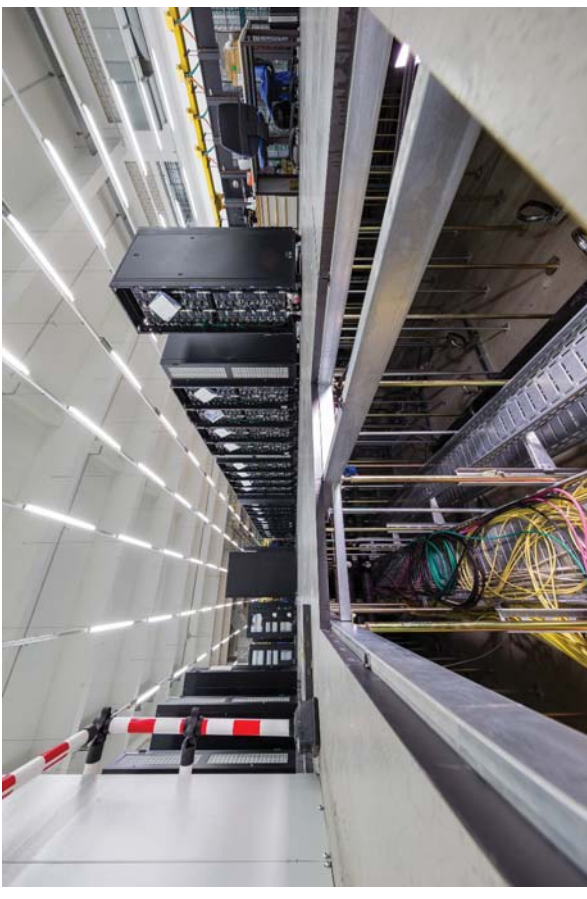
Abbildung 2: Blick in den Unterboden unter SuperMUC-NG (Foto: Lenovo)
